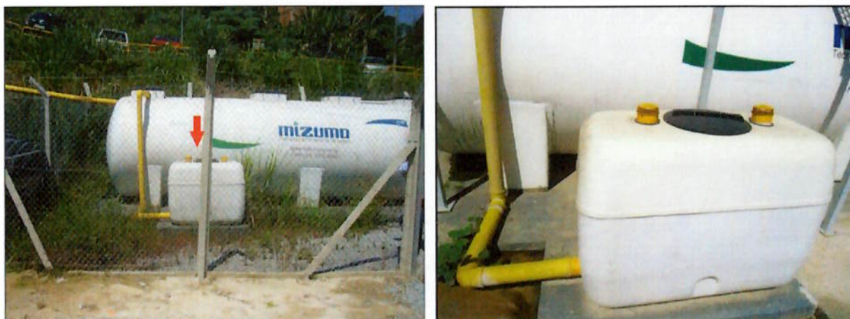
FIGURA 5 – Filtro de biogás instalado na ETE do canteiro de obras de General Carneiro, em Sabará – MG
