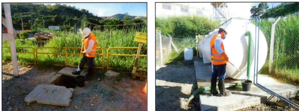
FIGURA 6 – Entrada e Saída da Estação de Tratamento de Esgoto do canteiro de obras de General Carneiro, Sabará – MG
