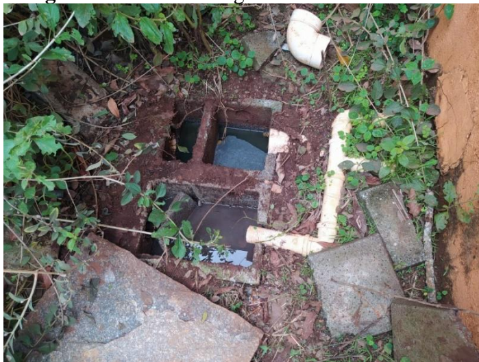
Figura 5.10 - Caixa de gordura de um dos chalés.
