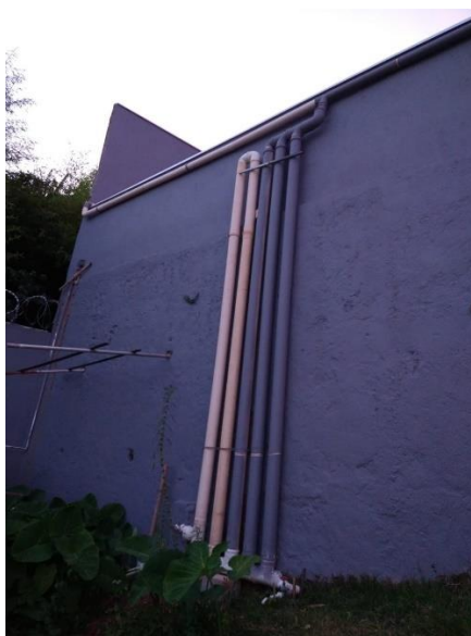
Figura 5.1 - Dispositivo de descarte da água de escoamento inicial.
