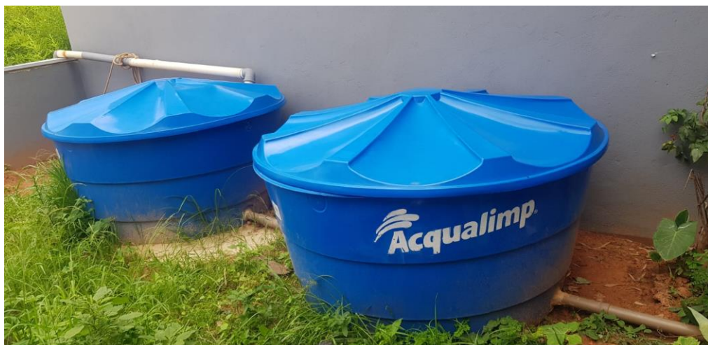
Figura 4.9 - Reservatórios interligados do SAAC.
