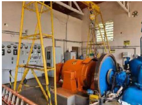
Figura 3.3 – Interior da casa de força da Central Geradora Hidrelétrica Santa Cecília
