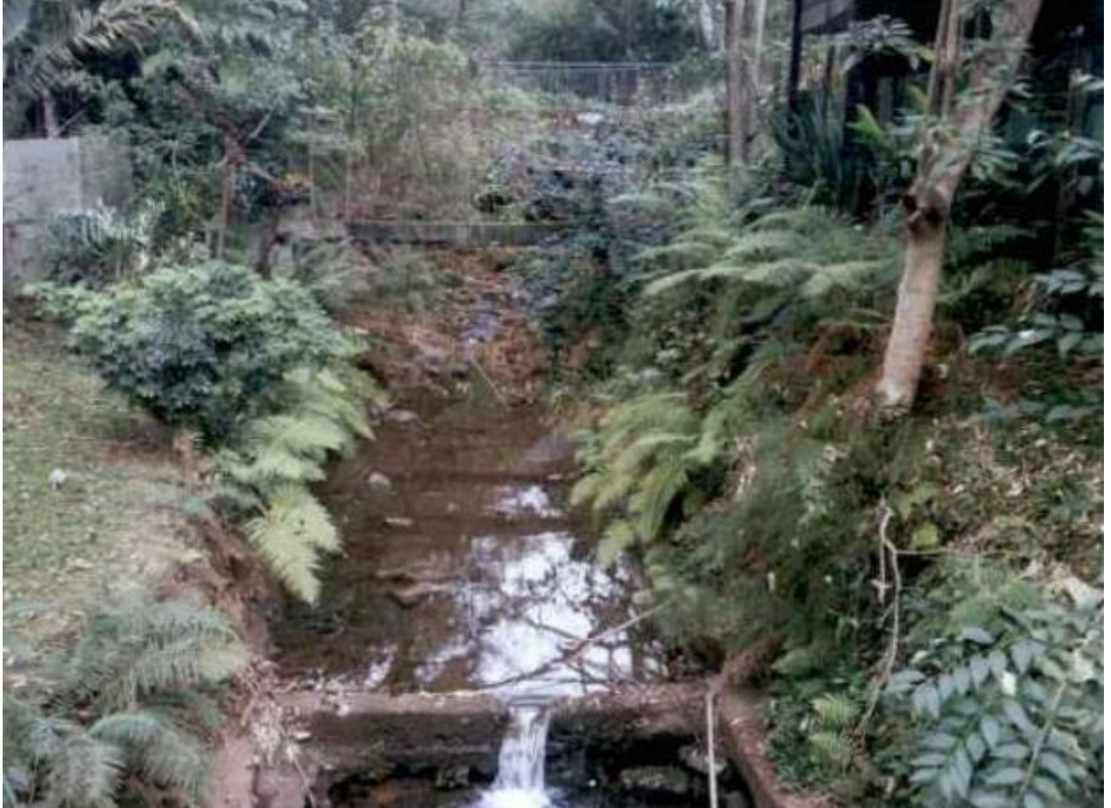
Figura 4.6: Trecho do Córrego que passa ao fundo do empreendimento, conforme os Estudos Hidrológicos e Hidráulicos do Córrego e Análise de Inundações referente ao processo nº501-061.964/14-84.
