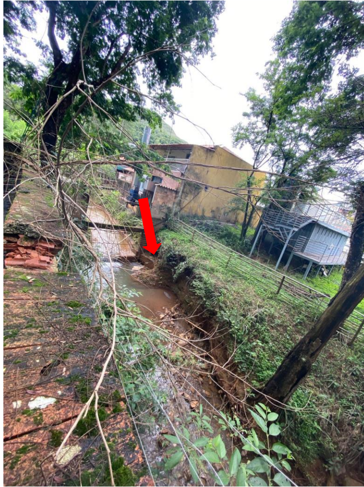
Figura 5.10: Presença de assoreamento, sinalizado por seta vermelha, em trecho do Córrego que passa no fundo do terreno.
