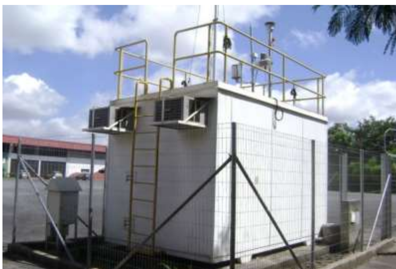
Figura 12 – Estação Automática Fixa de monitoramento de dados meteorológicos e de qualidade do ar (Estação CMMR – RMBH)
