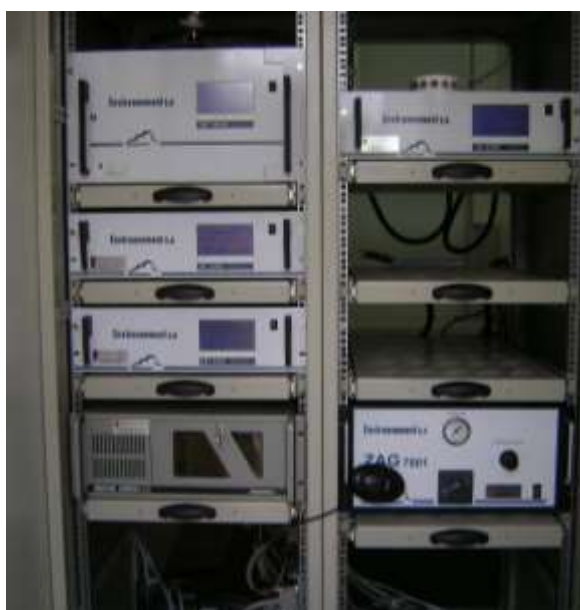
Figura 13 – Equipamentos no interior da estação de monitoramento
