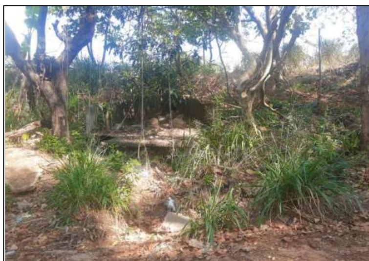
Figura 5.12 – Registro da visita de campo- Dispositivo de drenagem da Rua Divisa Santa, com lançamento inadequado na área do CEA Barreiro.
