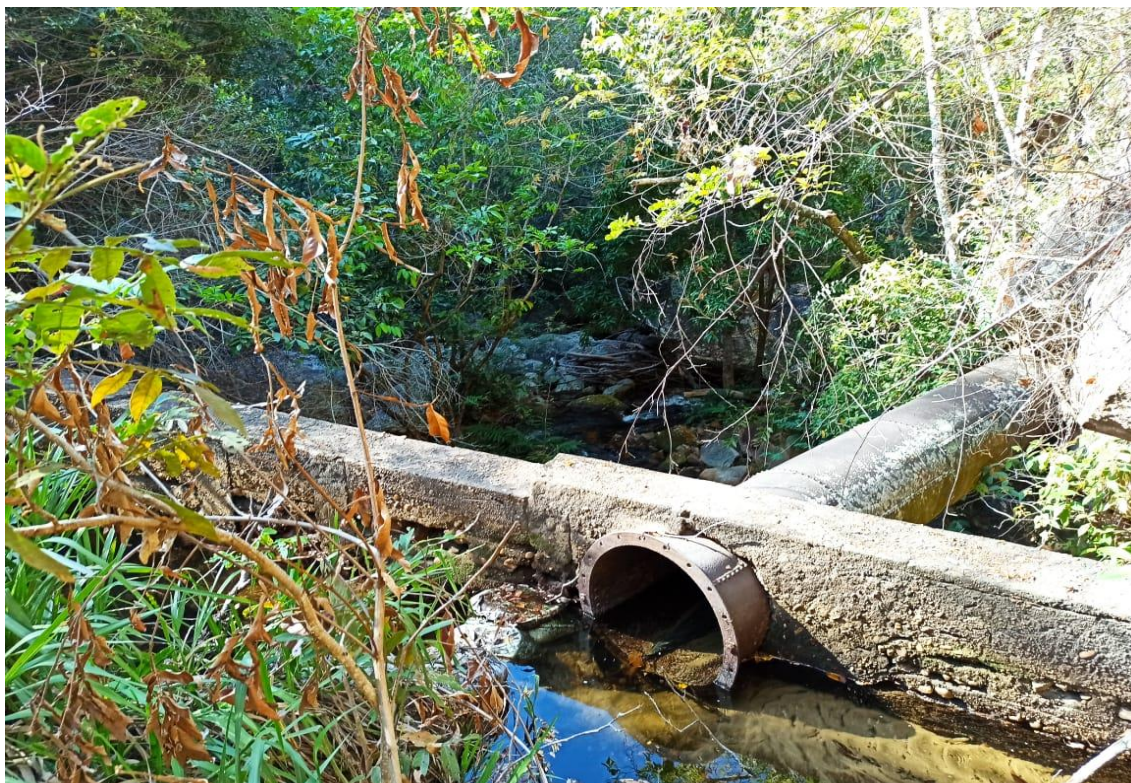
Figura 5.3 - Ponto de captação de água na trilha “Garganta do Diabo”.
